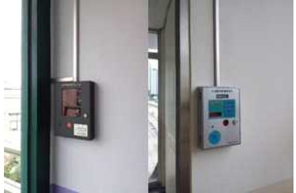
〈사례2 - 비상문자동개폐장치 설치〉
