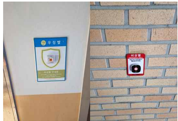
〈사례2- 건물 주변, 복도 비상벨 설치〉
