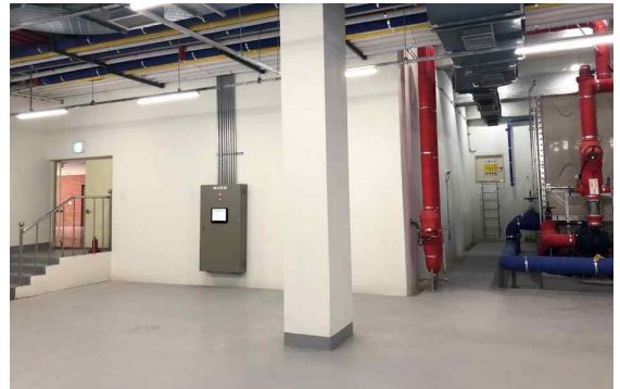
〈사례2 - (양호) 기계실 관리상태〉
