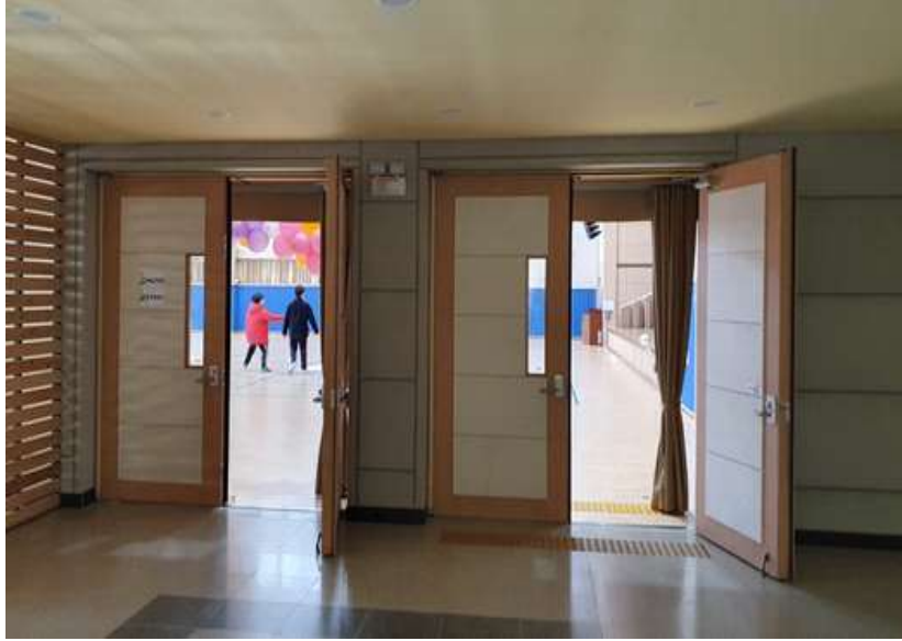
〈사례3 - 150cm 이상 충격흡수재 설치〉
